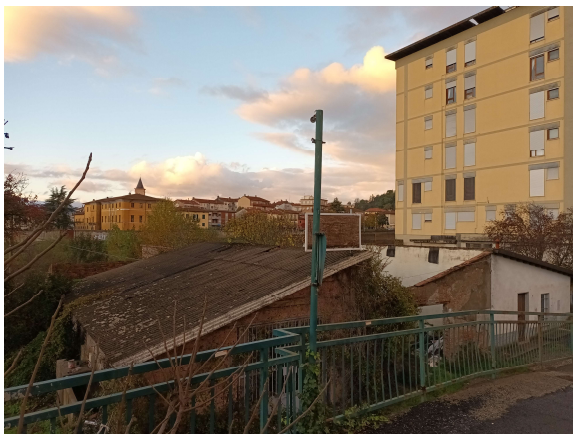
Copertura in amianto presente in fabbricati dell'aggregato A
