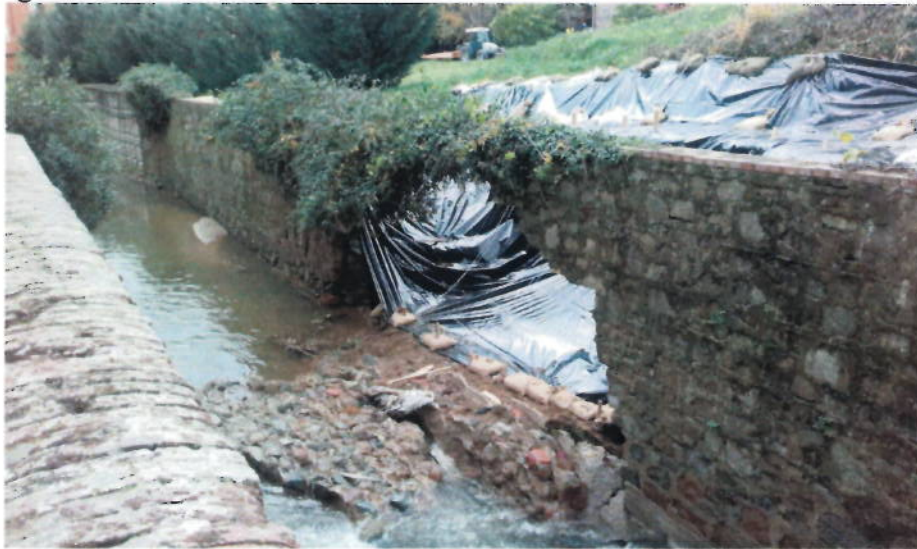
Vista 1° crollo di muro a monte
