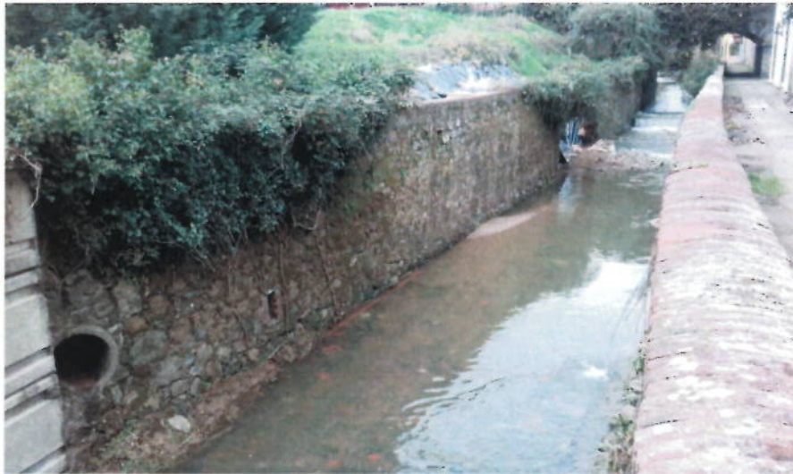
Vista - 1° crollo di muro a monte
