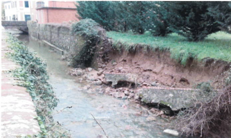
Vista 2° crollo di muro a valle
