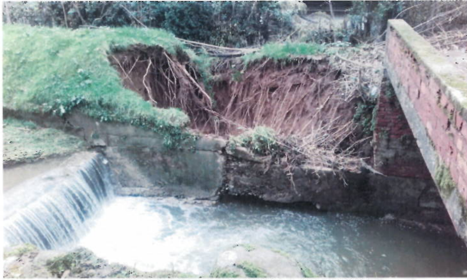
Vista cedimento in SX idraulica del Torrente
