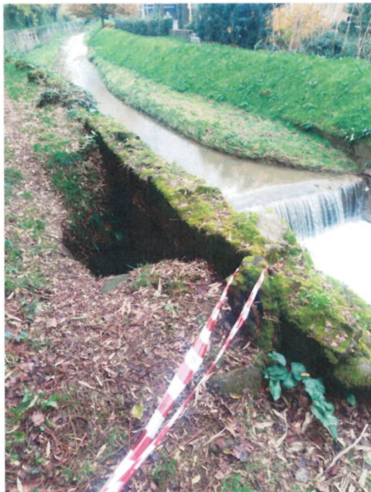
Vista cedimento in DX idraulica del Torrente
