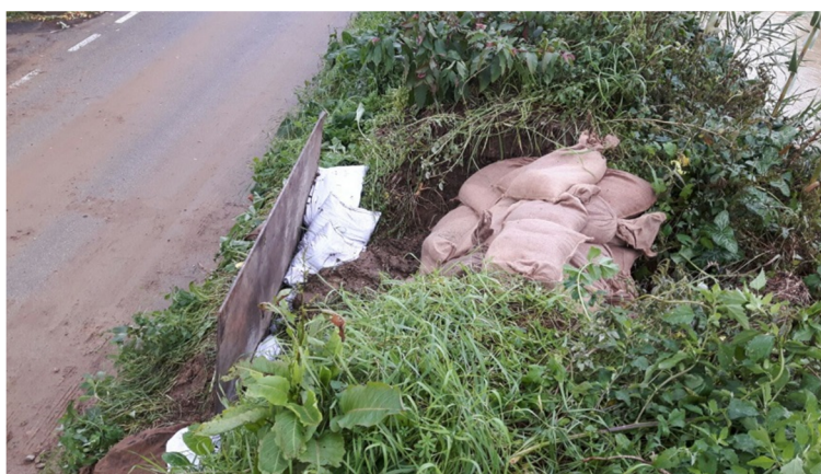
Figura 17: Intervento C situazione post evento
