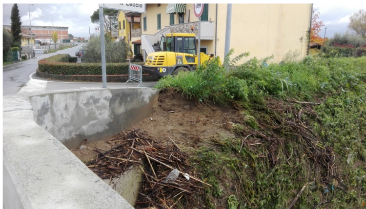
Figura 19: erosione dei paramenti arginale a monte del ponte di Via Diaccio
