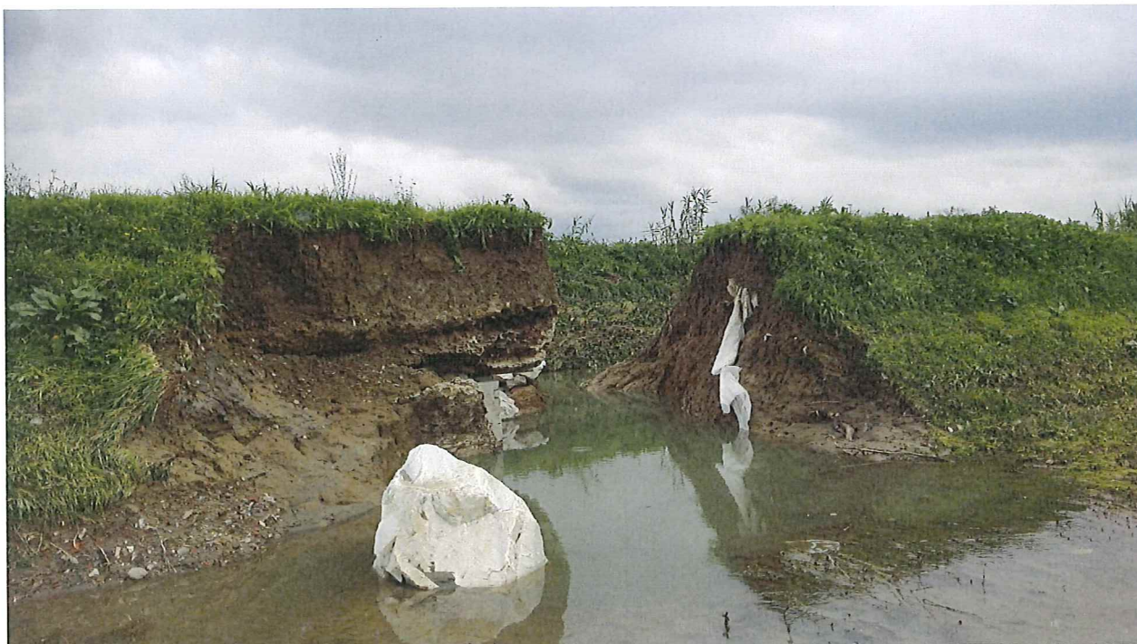
Vista rotta arginale lato campagna
