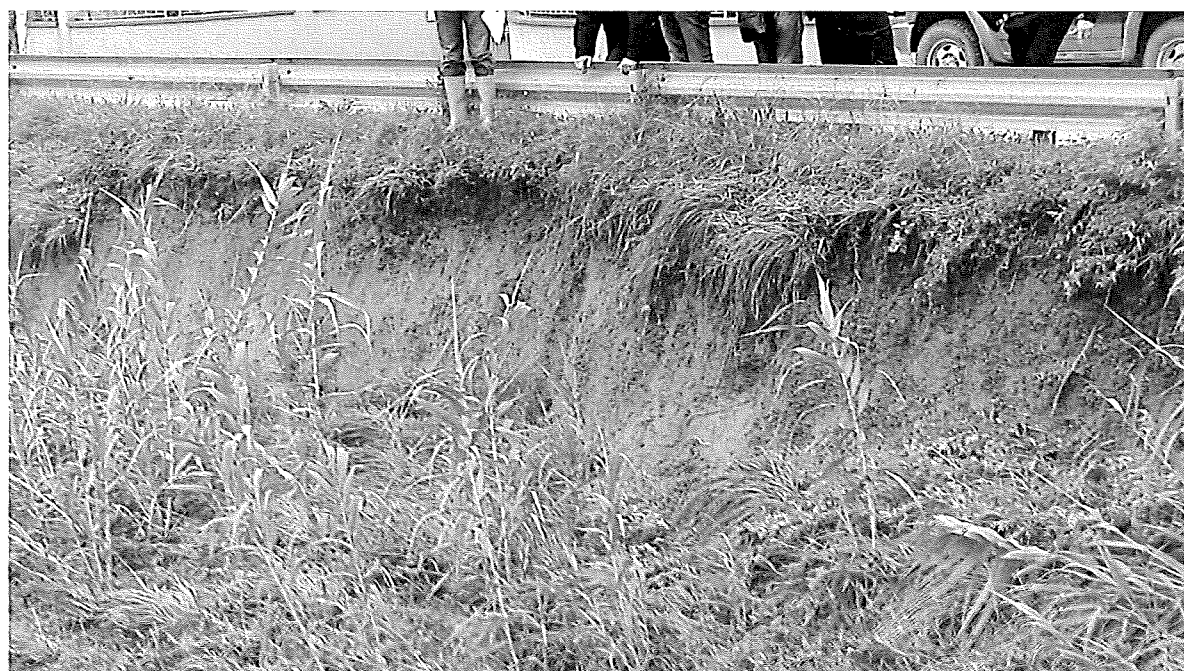
Foto 2: Vista della seconda erosione arginale
